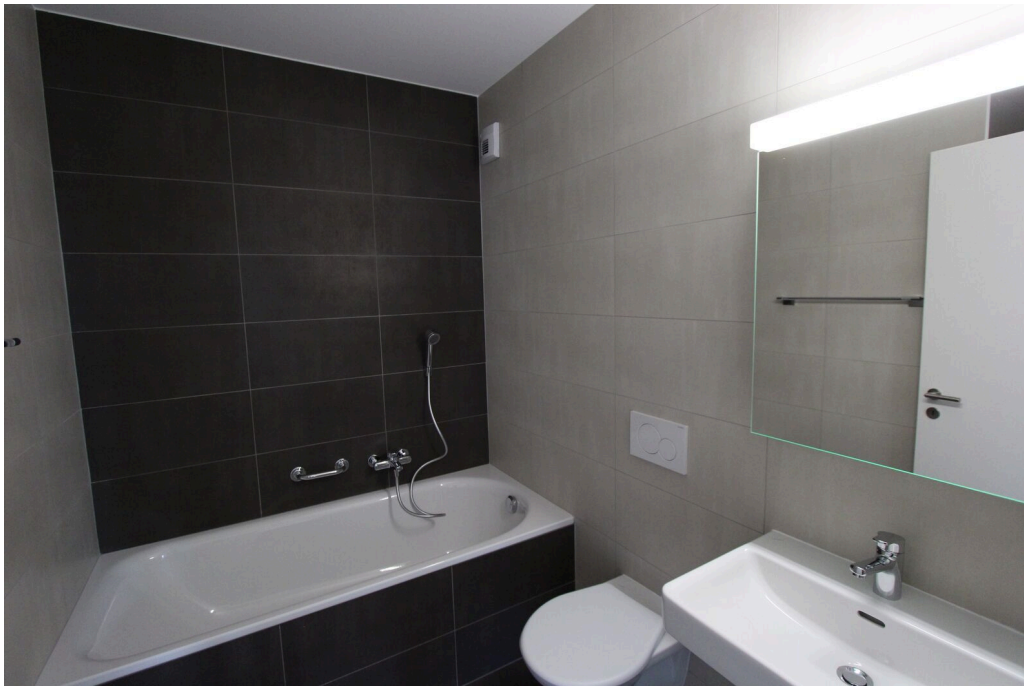
Salle de bain avec colonne de lavage
